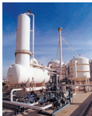
Μονάδα Ανάκτησης Ατμών στις φορτώσεις βυτίων
